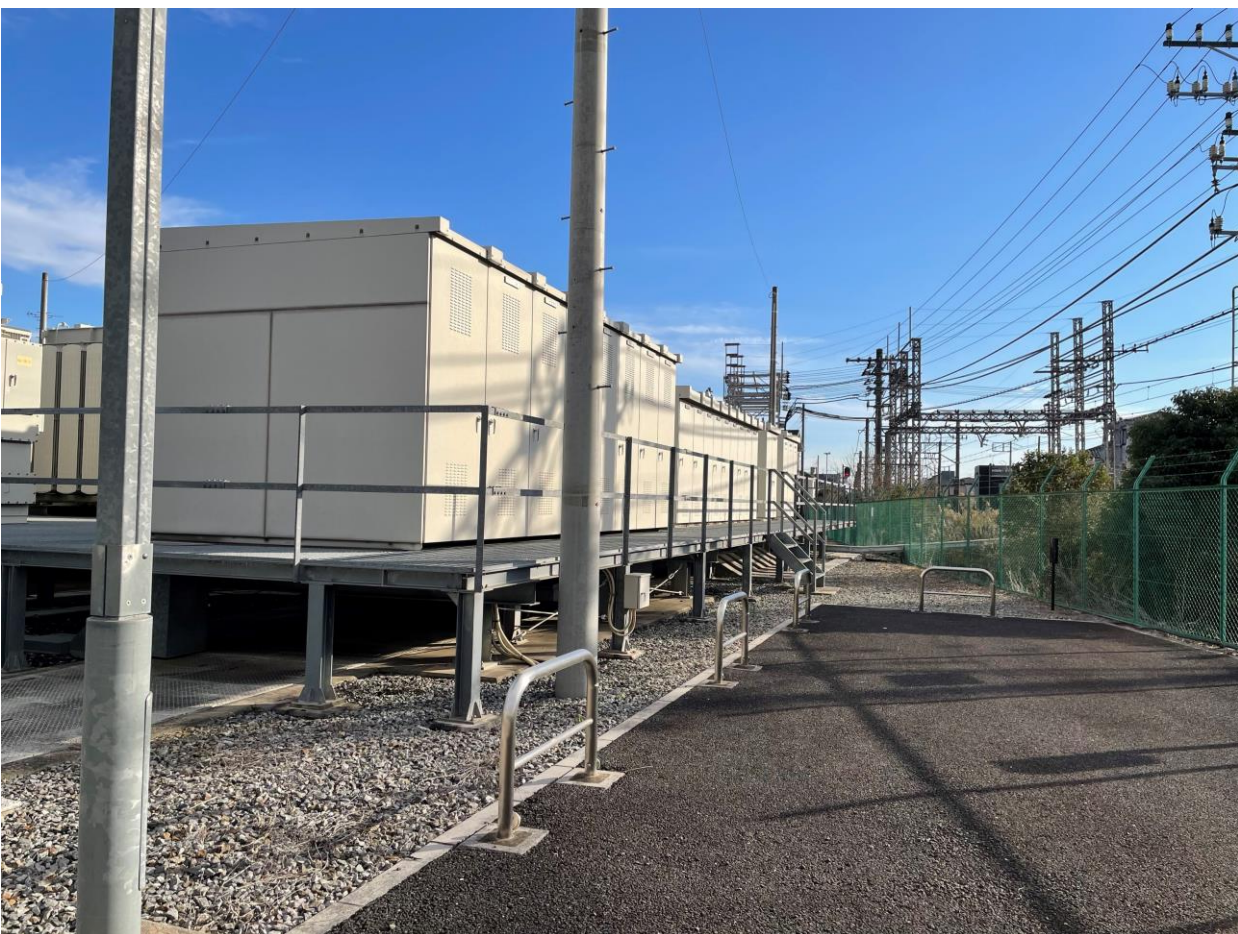
かさ上げが行われている東武鉄道の変電所 (撮影：浅田晴輝)
